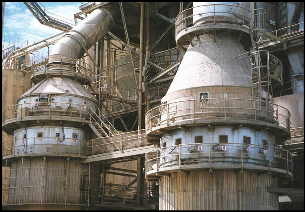
Şekil 2.8. Kuru tip gaz temizleme tesisi elektrofiltreleri (TAPC,2020)
