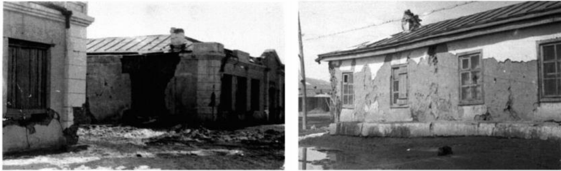
Resim 1.1. 1970 yılında Ulan Batur'da don kabarması sebebiyle hasar görmüş yapılar (Dalai, 2010)
