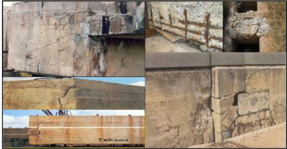
Şekil 3.16. Beton malzemenin zamanla donma-çözünme sonucu tahribatı
