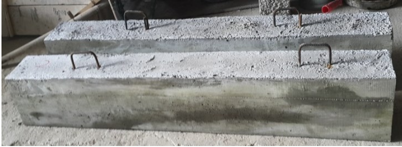
Şekil 3.18.28 günlük kür işlemi sonrası kirişlerin durumu
