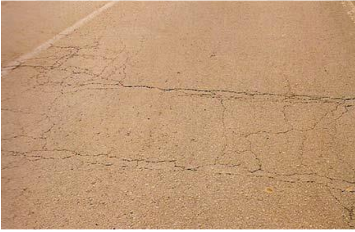
Resim 3.9. Orta şiddette termal çatlak
