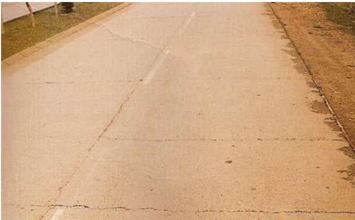
Resim 3.10. Yüksek şiddette termal çatlak
