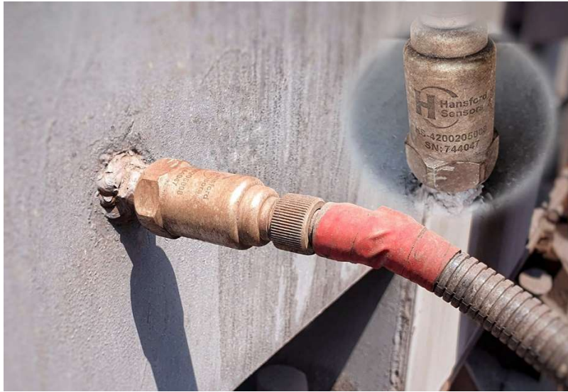
Resim 3.6. Fan motoru gövdesindeki vibrasyon sensörü
