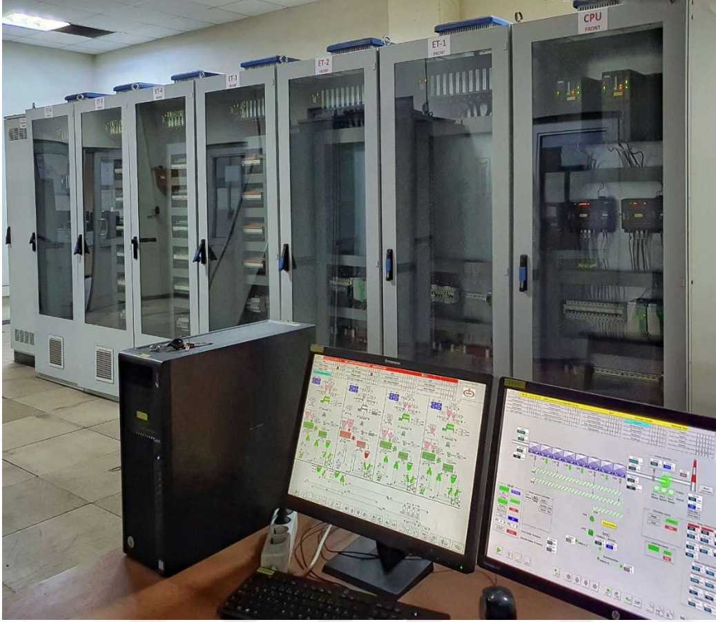
Resim 3.12. Sinter Fabrikası S7-400 PLC panosu ve ES bilgisayarları görüntüsü
