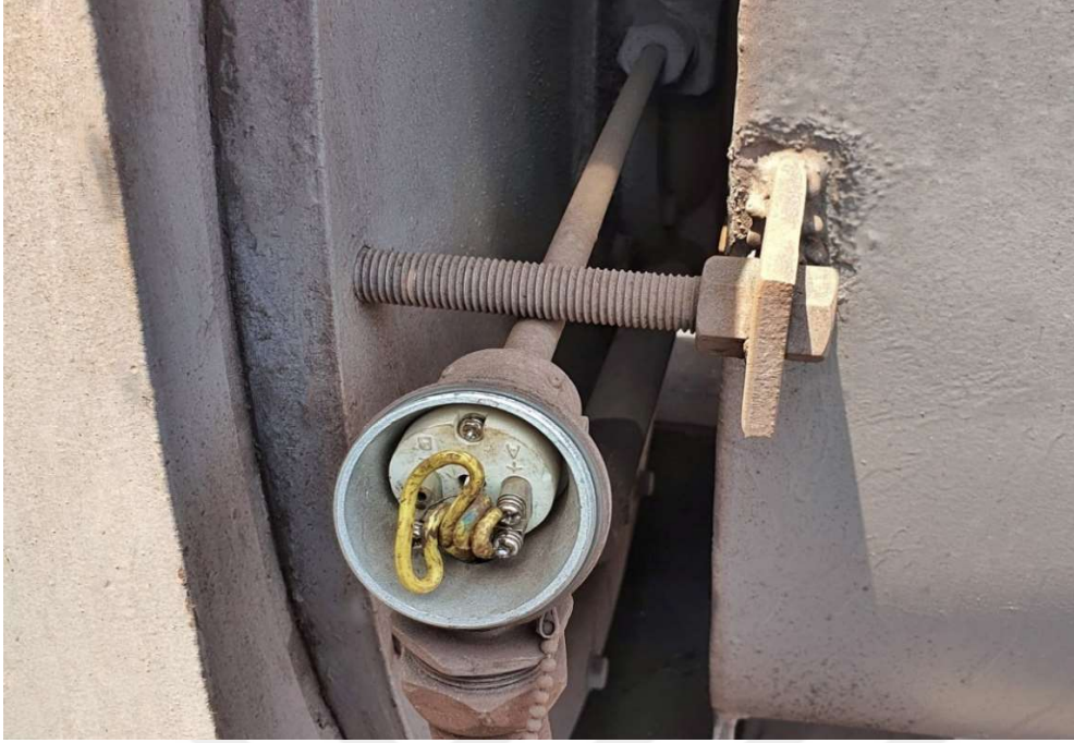
Resim 3.8. Fan motoru rulman yatak sıcaklığı sensörünün metal koruması ve terminal bağlantı kutusu ile sahadaki uygulaması
