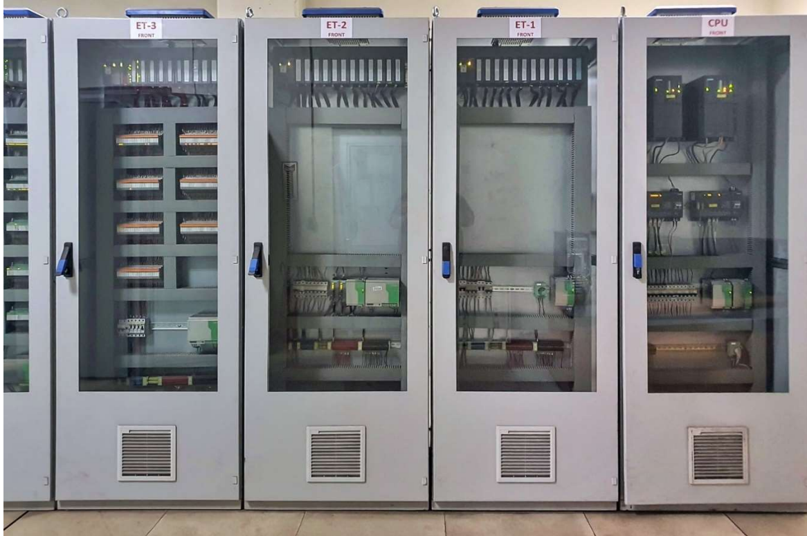
Resim 3.1. Siemens S7-400 CPU ve sinyal modülleri içeren PLC panosu
