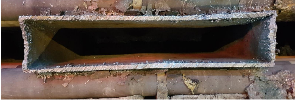
Resim 2.2. Slab yırtılması sonrası geriye kalan içi boşalmış slab kovanı
