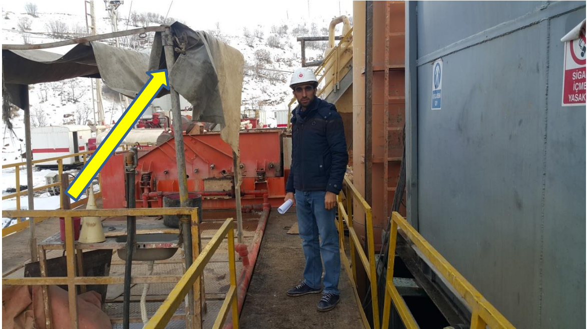
Resim 4.7. Koruyucu çadırın uygunsuzluğu
