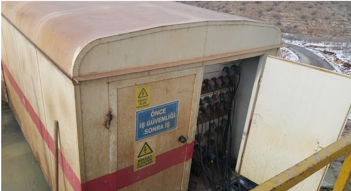
Resim 4.5. Kapağı açık uygunsuz elektrik panosu
