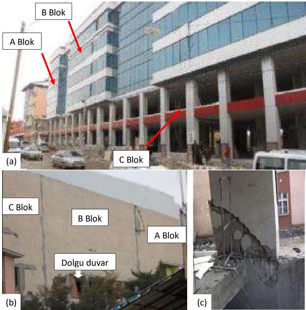
Şekil 1.3. Burulma etkisi sonucunda ağır hasar almış yapı, (a) dolgu duvarsız ön cephe, (b) dolgu duvarlı arka cephe, (c) bir kolondaki hasar görüntüsü [40]
