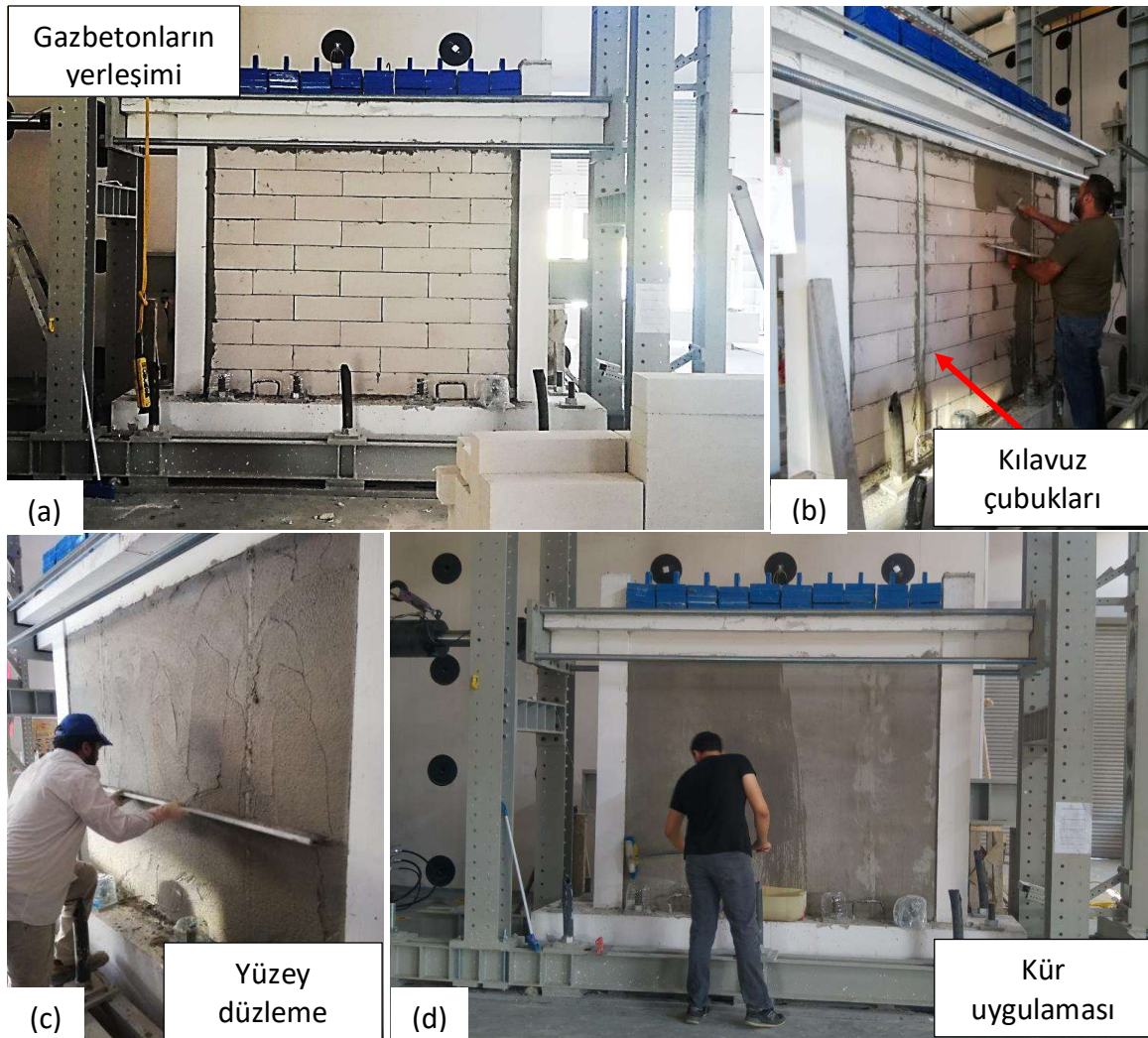
Şekil 2.15. GÇ numunesinin dolgu duvar imalatı, (a) duvar örümü, (b, c) sıva aşaması, (d) kür işlemi
