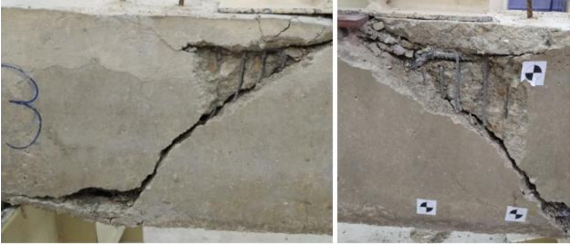
Şekil 4.7. DYNØ4 çatlak ayrıntıları
