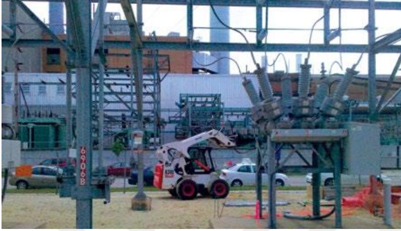
Şekil 2.19. Bir trafo merkezindeki sınırlı alana helisel kazıklar kurulumu yapan mini yükleyici (Blessen vd., 2019)
